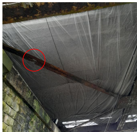
Figures 8 : Contreventement très fortement corrodé
