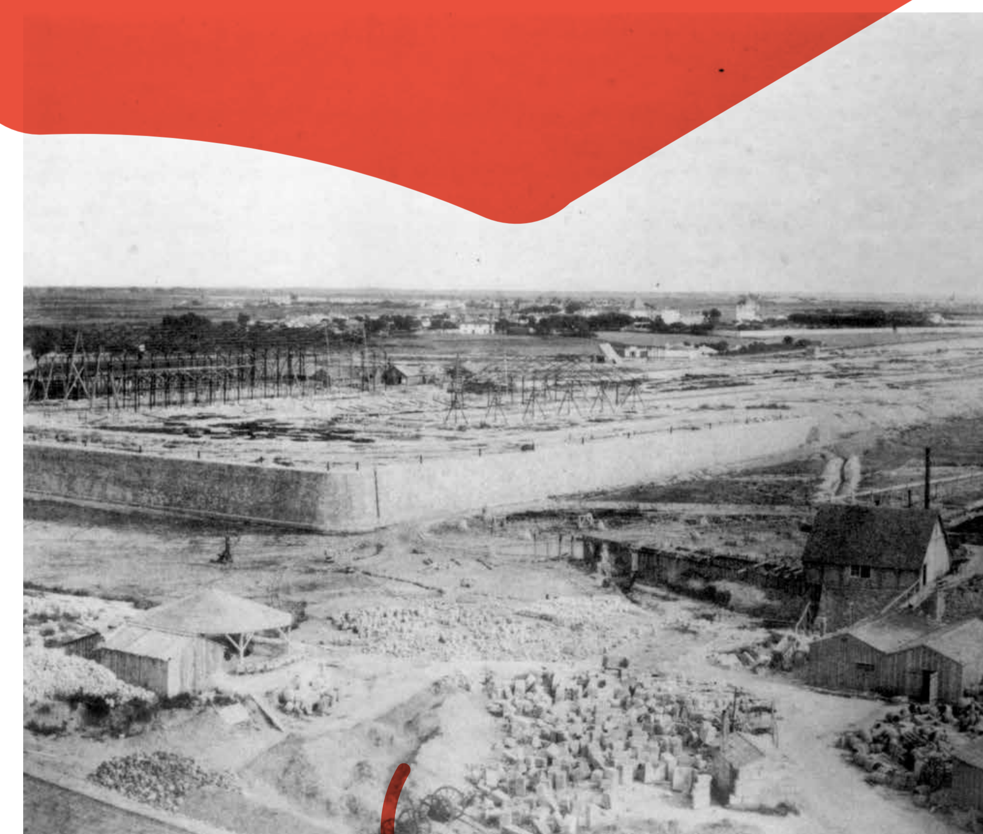
Travaux de construction du bassin à flot extérieur et de la première gare ferroviaire.
